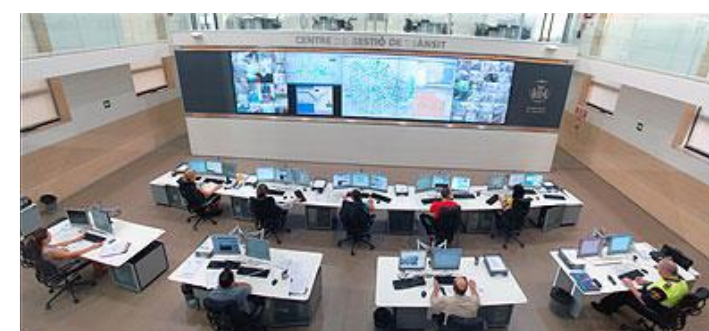
CENTRO DE CONTROL DEL TRÁFICO
