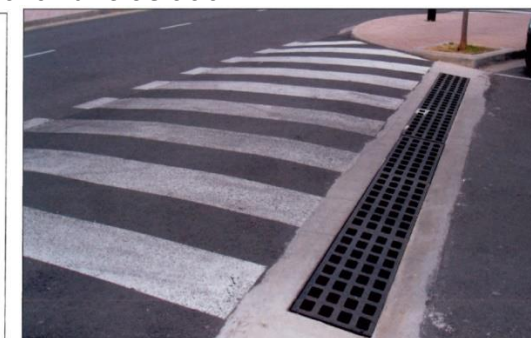
Canalización del agua en lomo.
