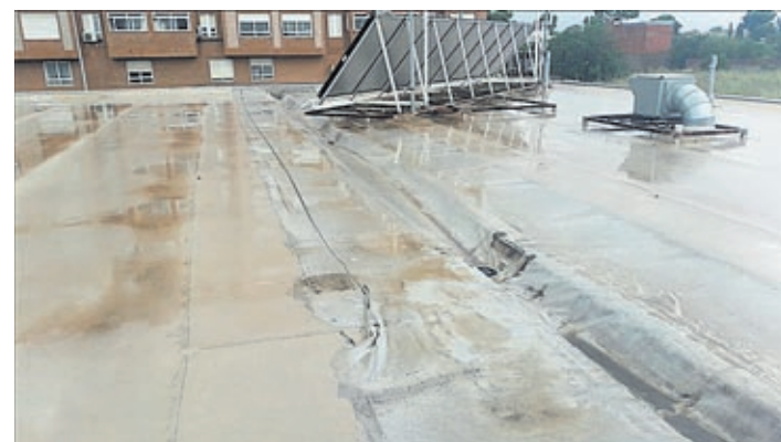
Imatge d'arxiu de l'estat del sostre que cal substituir al CEIP José Soriano.
