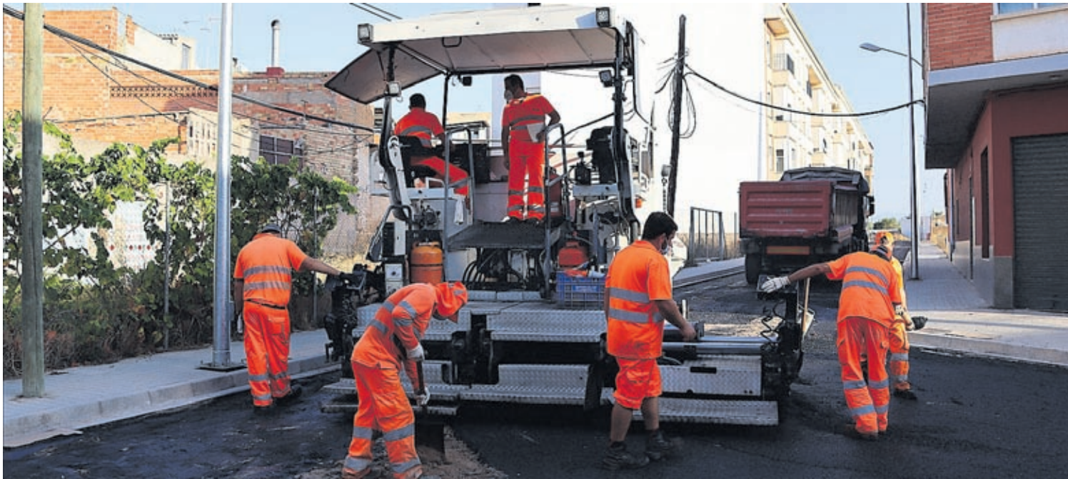
En este tramo, en el que ya han trabajado los operarios para asfaltarlo, hay una promoción de viviendas inacabada que supone un foco de peligrosidad e inseguridad.
