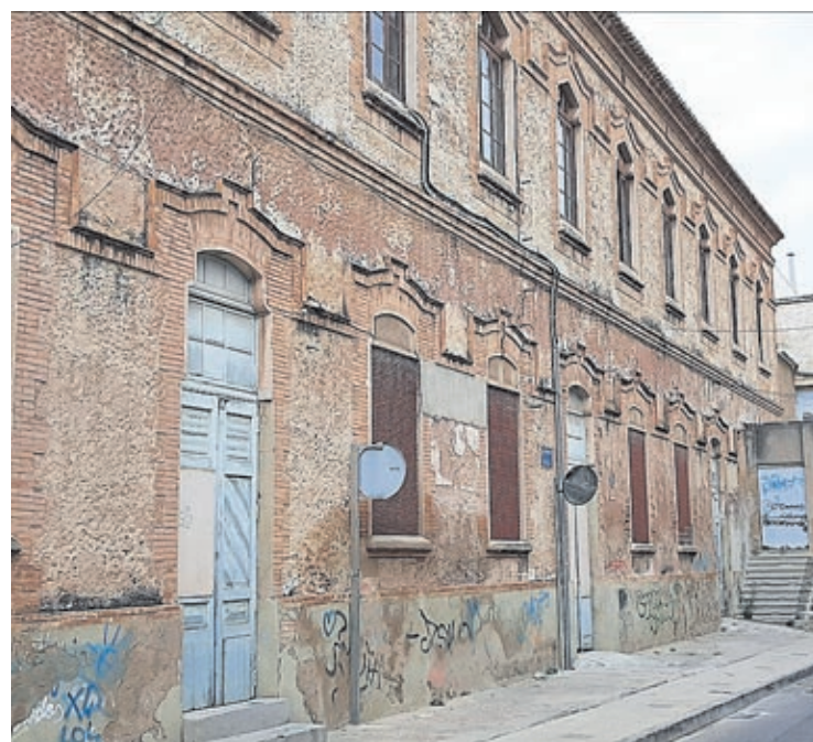
La fachada en mal estado da a la calle Molí y su reforma costaría 80.000 euros.
