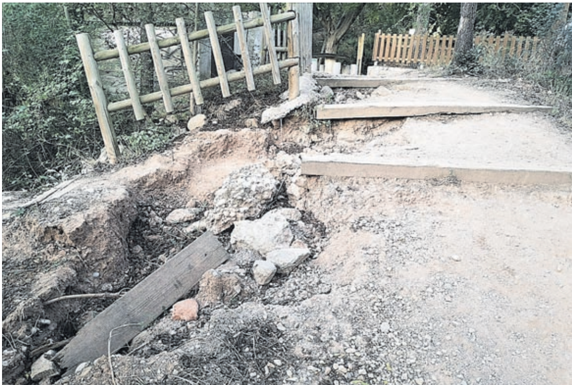
Las riadas o el mayor flujo de usuarios por la Ruta Botànica están detrás de los daños que presenta el paraje.
