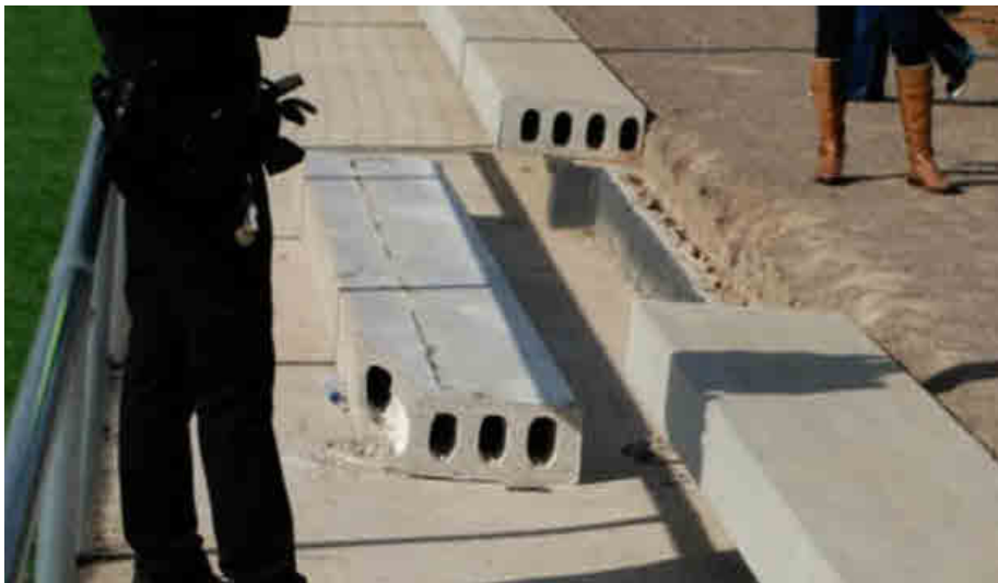
Imagen, de noviembre del 2016, de la caída de la plancha que causó lesiones a un menor.
