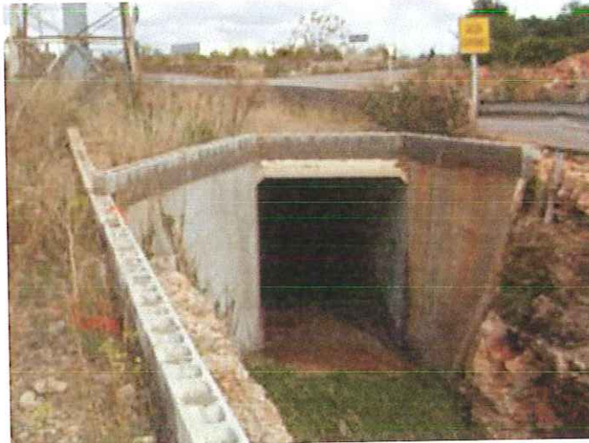
Foto 15: Conexión a Drenaje exterior
