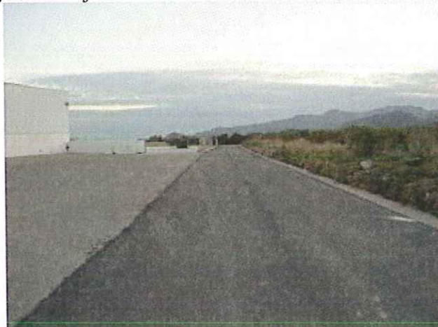
Foto 29: Calle Ralla, sentido calle La Costera.
